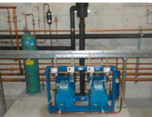
Du R404A au R449A. Les travaux de remplacement ont pu être effectués en quelques heures et l'interruption n'a pas eu de répercussion sensible sur les produits réfrigérés.
